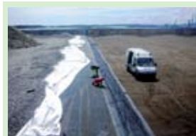
2006-2007 Хранилище промышленных отходов, Швеция 8.000+42.000 m 2
